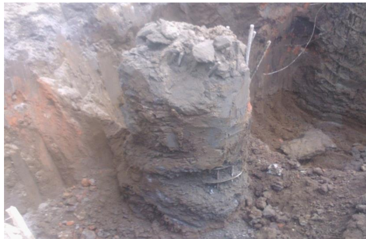
Gambar 2.8. Material Beton Bored pile tercampur dengan Lumpur (Dokumentasi Pribadi)
