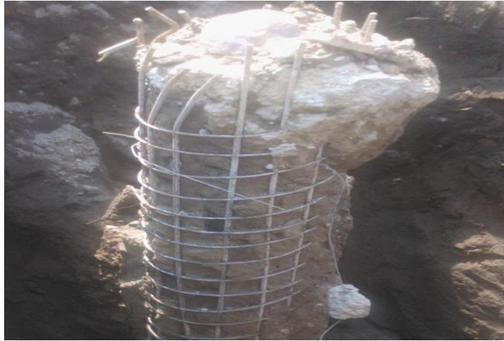
Gambar 2.9 Tidak Menyatunya Tiang Bored pile antara Besi dengan Beton (Dokumentasi Pribadi)
