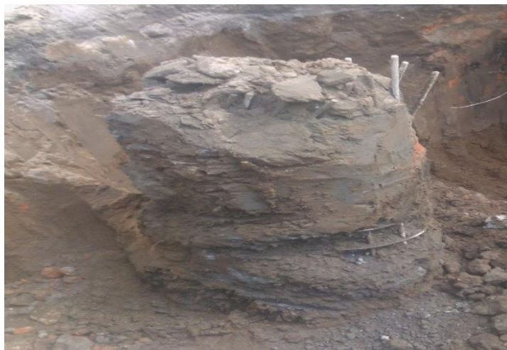
Gambar 2.10 Tiang Bored pile tidak Tegak Lurus (Dokumentasi Pribadi)
