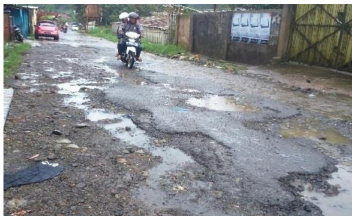
Gambar 1.2. Permasalahan Kerusakan Perkerasan pada Jalan Raya (Ayo Media Network 2016)
