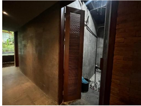
Gambar 2. 27 Plumbing Room The Bali Eden (Sumber: Dokumen Pribadi, 2026)
