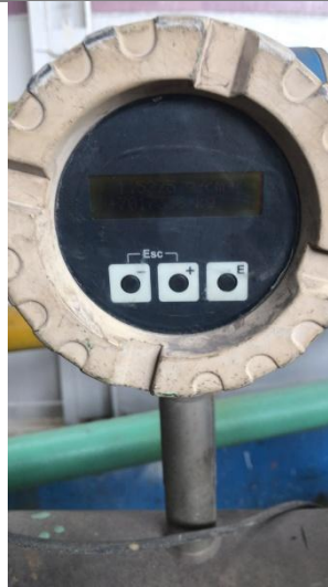
Gambar 4.18 Dokumentasi Pengambilan Data Flowmeter di Plan
