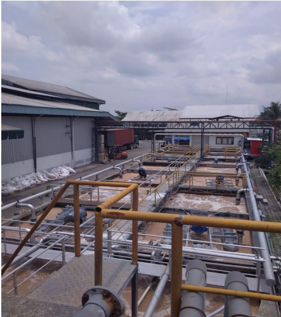
Gambar Instalasi Pengolahan Air Limbah PT Z
