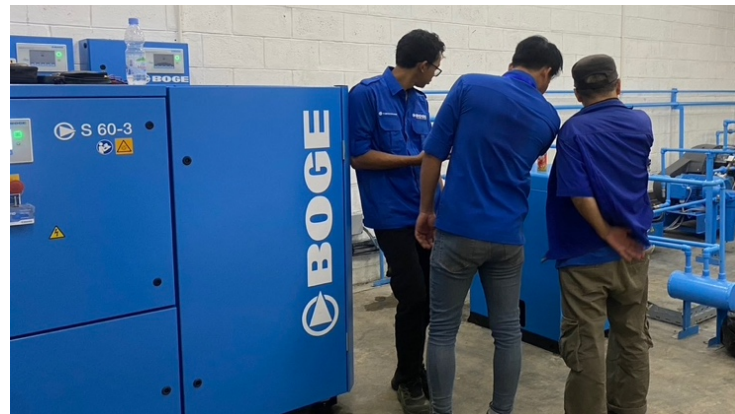
Gambar 4. 6 Dokumentasi Instalasi Unit Kompresor Sumber: Dokumentasi Peneliti, 2026
