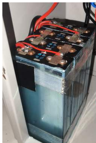
Gambar 4.3 Instalasi Baterai \text{LiFePO}_4 di dalam Box Panel
