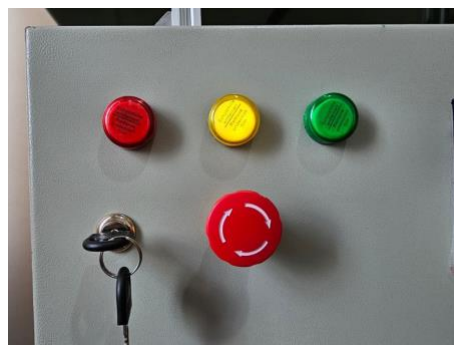
Gambar 4.45 Kondisi Pilot Lamp Saat Sistem Idle
