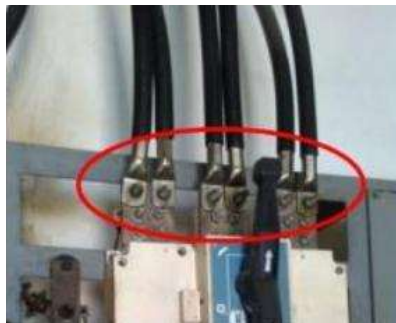
Gambar 2.4 Unit Masukan ( Incoming ) PHB-TR
