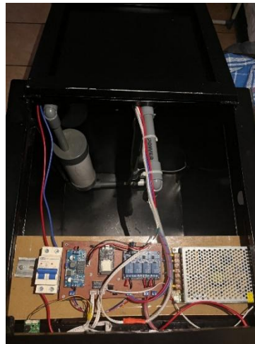
Gambar 4. 12 Tampak Keseluruhan Komponen pada Kotak Pengisian Galon
