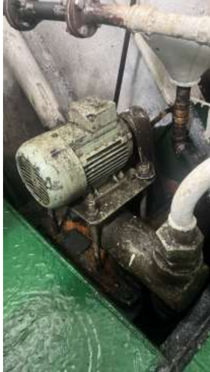
Gambar 2. 6 Pompa (Sumber : Penulis, 2025)
