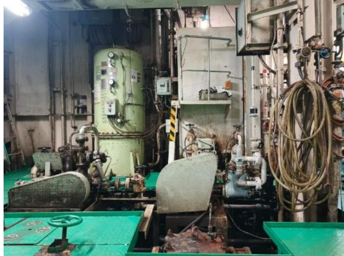
Gambar 2. 2 Oily Water Separator (Dokumentasi Pribadi)
