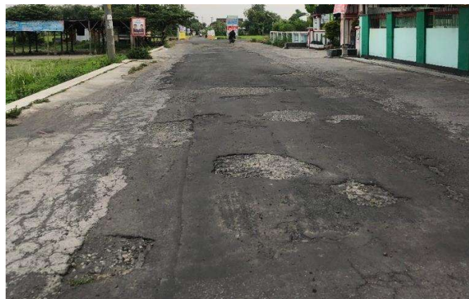
Gambar 1.2 Kerusakan Infrastruktur Jalan Di Kab. Boyolali
