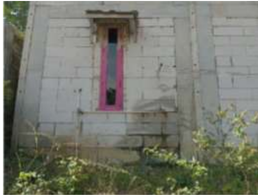
Gambar 5. 2 Kondisi Existing Dinding yang Berjamur dan Berlumut Sumber: Dokumentasi Penulis, 2025
