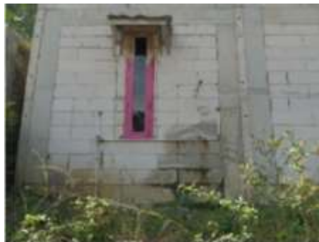
Gambar 1. 3 Kondisi Dinding yang Basah, Berjamur, dan Lembap
