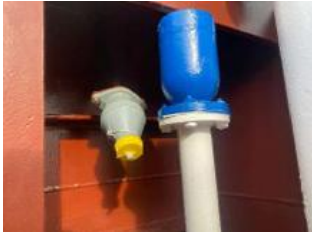
Gambar 2. 12 Sistem Drainase (Sumber : Dokumentasi Pribadi)
