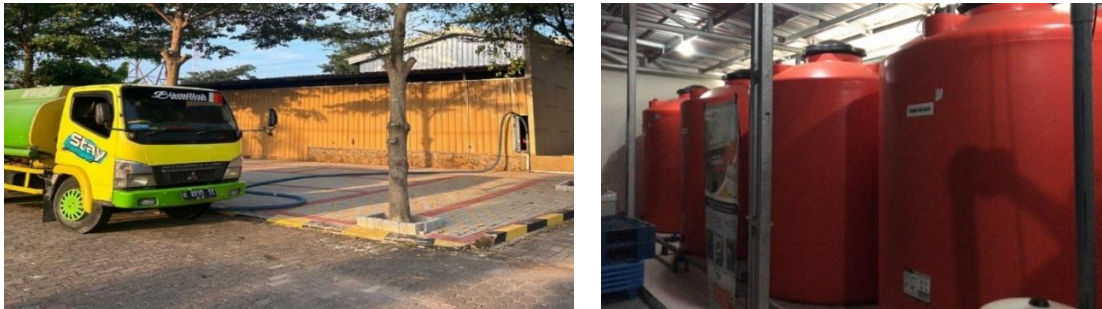
Gambar 4. 6 Proses Penyaluran Air Baku ke dalam Tangki Air Penyimpanan Sumber: Data Perusahaan, 2025
