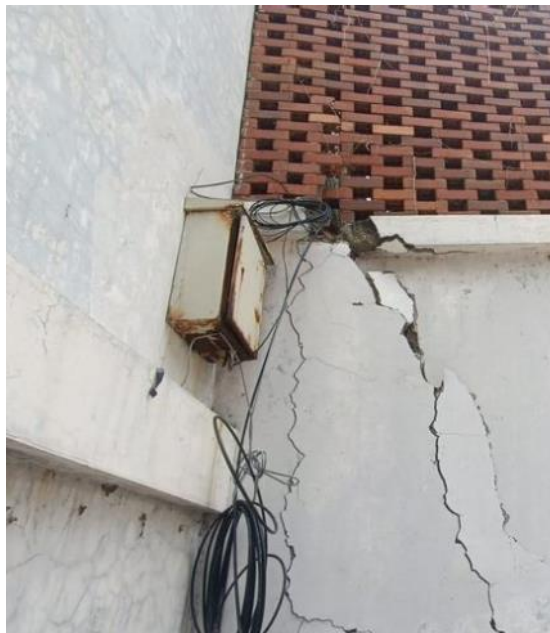
Gambar 1. 3 Kerusakan Pada Fasilitas RPTRA Sumber Gambar: Kompas.com, 2023
