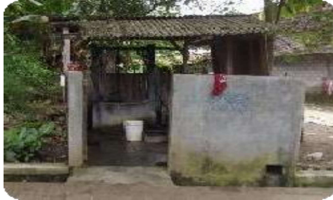
Gambar 2. 3 Kondisi Sanitasi Tidak Sesuai Persyaratan Teknis
