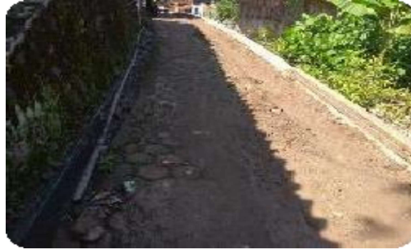
Gambar 2. 6 Kondisi Drainase Lingkungan Buruk
