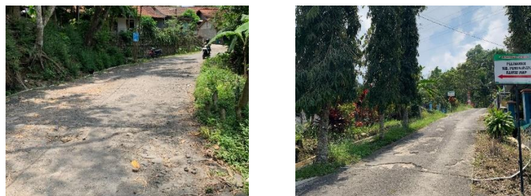
Gambar 2.5 Kondisi Infrastruktur Jalan Menuju Puskesmas Padureso
