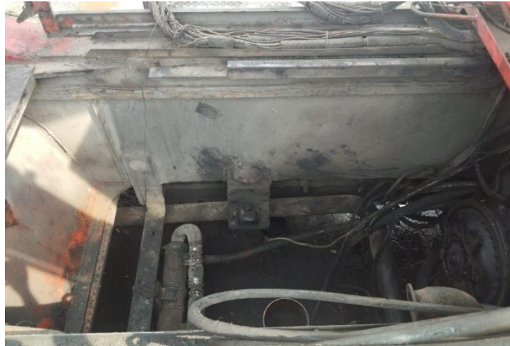
Gambar 4 . 6. Kerusakan dan Pembongkaran Alat
