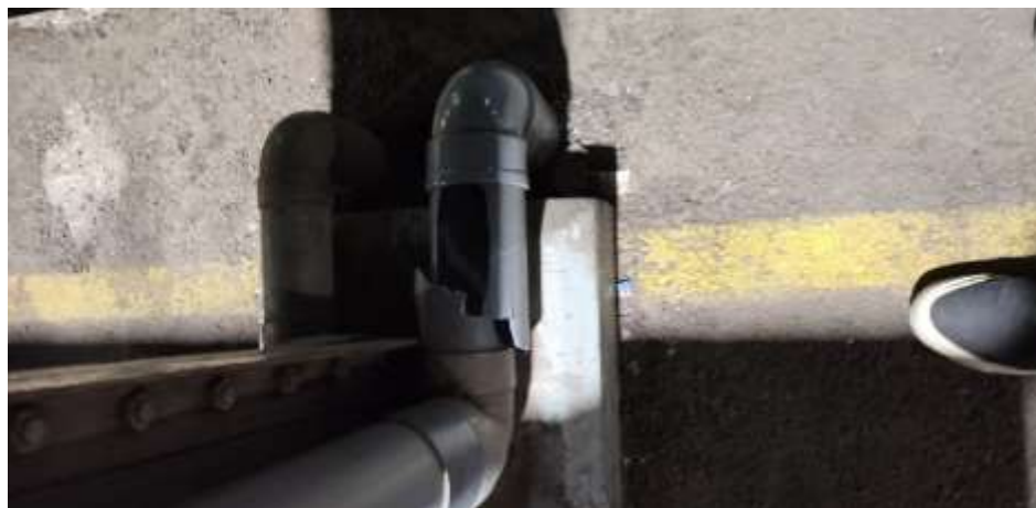
Gambar 4. 6 Kerusakan Pipa Saluran Air
