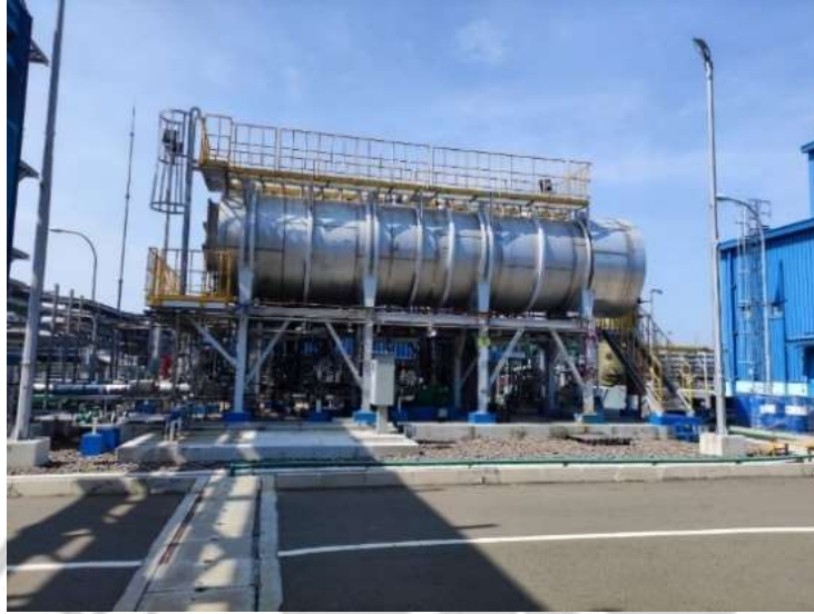
Gambar 2. 2 Desalination Plant tipe MED di PLTGU Priok
