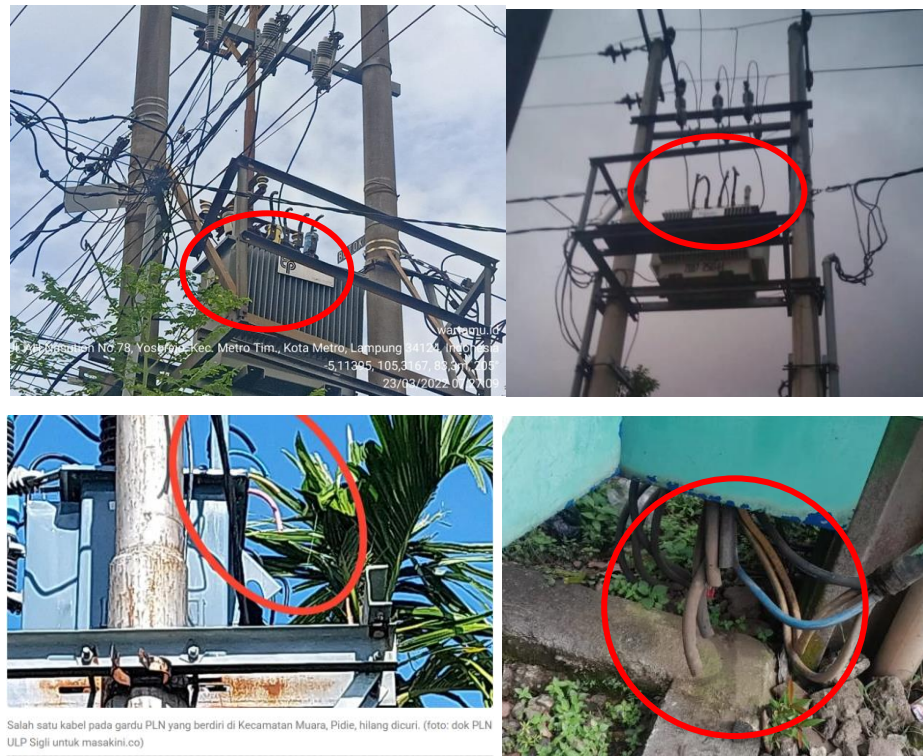
Gambar 2. 2 Kabel yang telah putus akibat pencurian
