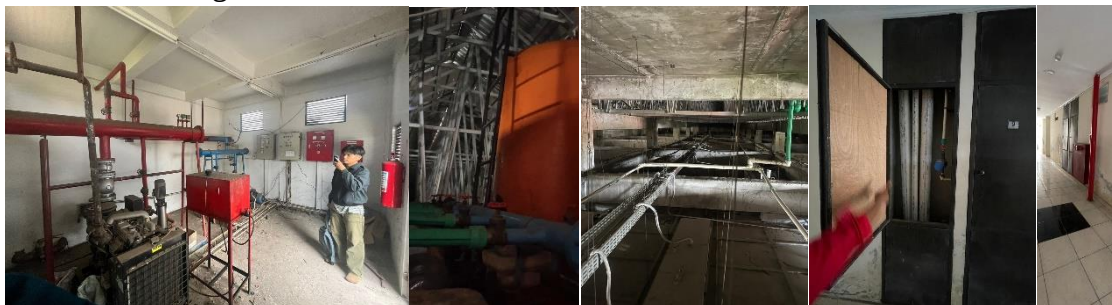
Gambar 2.36 Utilitas Bangunan Rusun Jarakah
