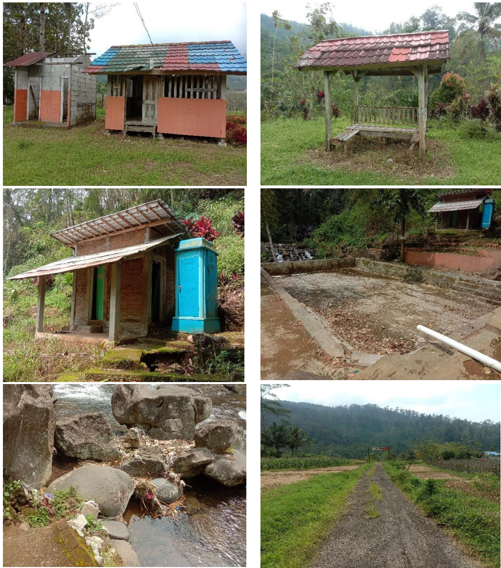
Gambar 1.3 Sarana dan Prasarana yang Tidak Terawat dan Rusak
