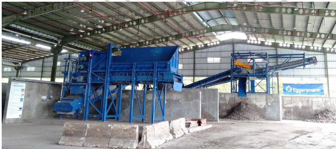
Gambar 4 Mesin Pengayakan pada Fasilitas RDF
