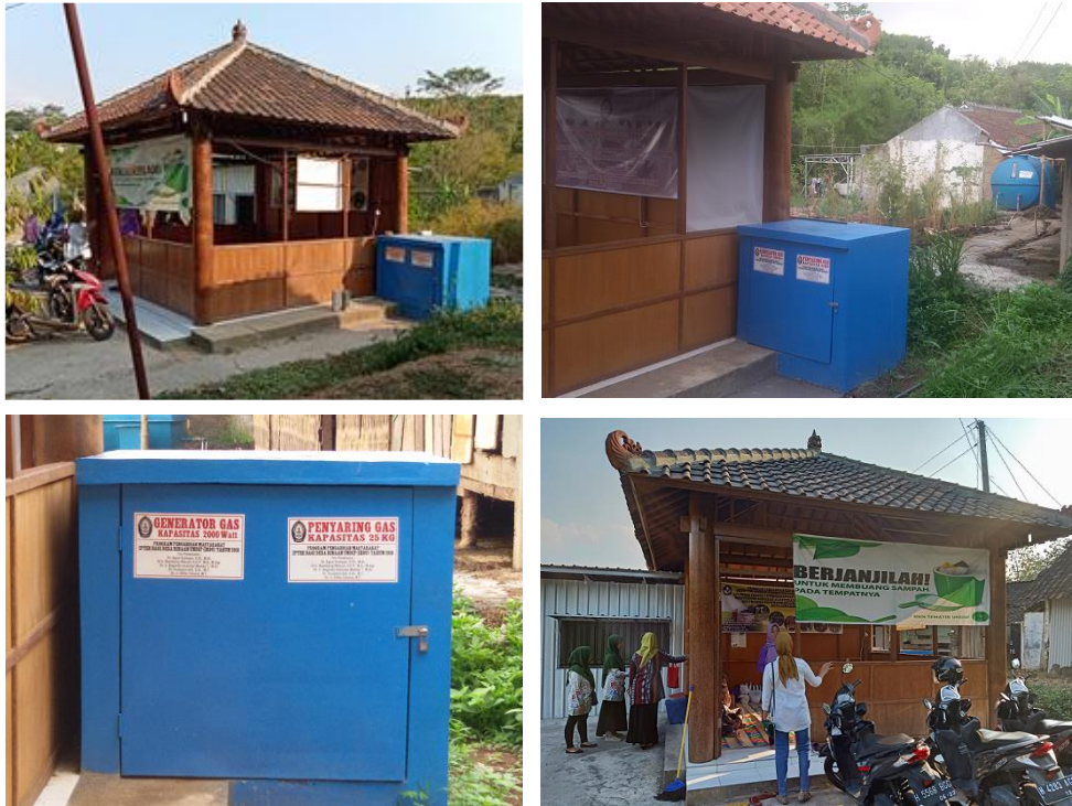
Gambar 7. Penempatan genset di dekat gasibu sebagai pusat kegiatan.
