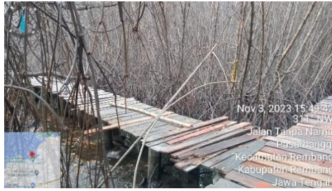
Gambar 1. 3 Area Jembatan Ditutup karena Kayunya Rapat
