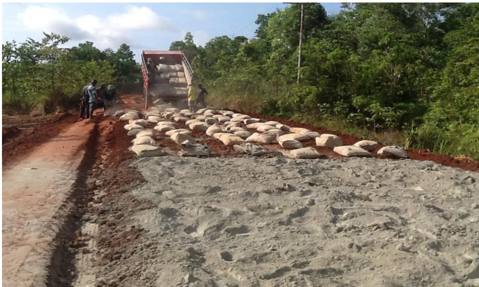
Gambar 1.6. Pekerjaan pembangunan jalan dari pasir galian - material lokal Merauke ( rigid pavement - soil cement )
