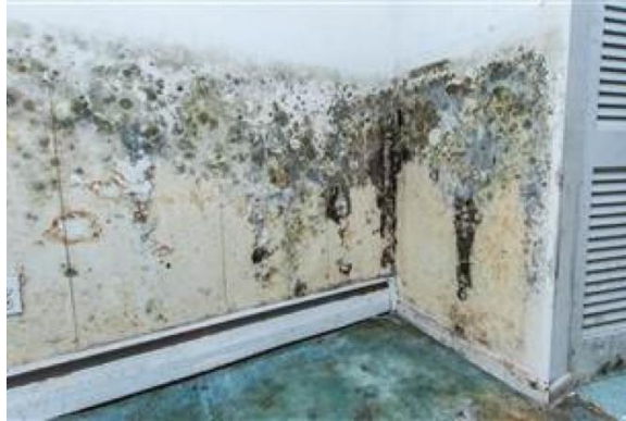
Gambar 1. 1 Dinding Berlumut dan Berjamur Sumber : Dokumentasi Pribadi
