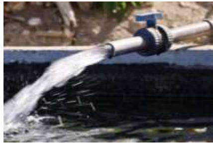
Gambar 3. 31. Aliran air dari heat exchanger
