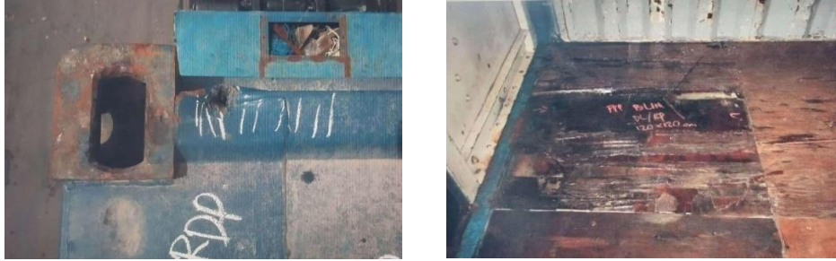
Gambar 1.1 Container rusak akibat benturan dan faktor usia
