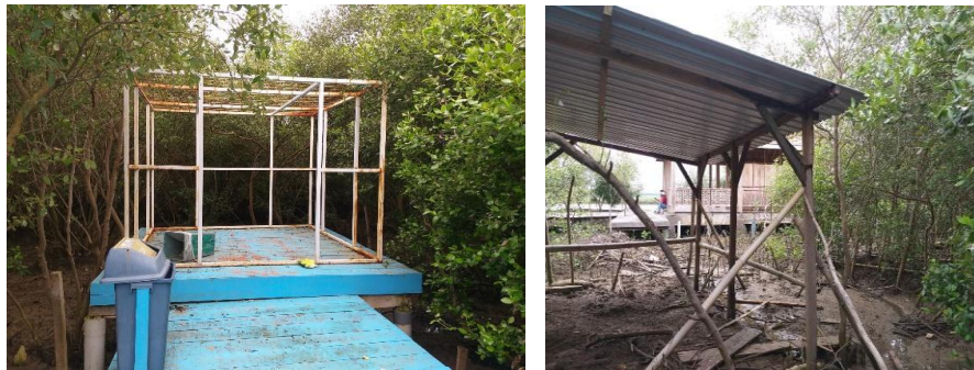
Gambar 1.2 Rusaknya Spot Foto dan Fasilitas Umum Desa Wisata
