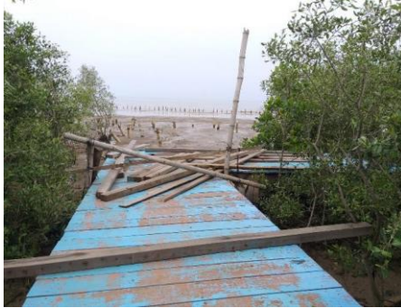
Gambar 1.1 Rusaknya Trek Jalan Kaki
