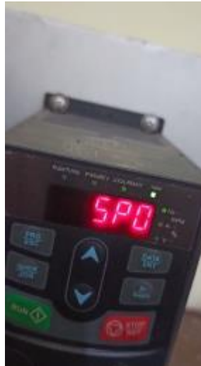
Gambar 3.33. Pesan malfungsi pada inverter.
