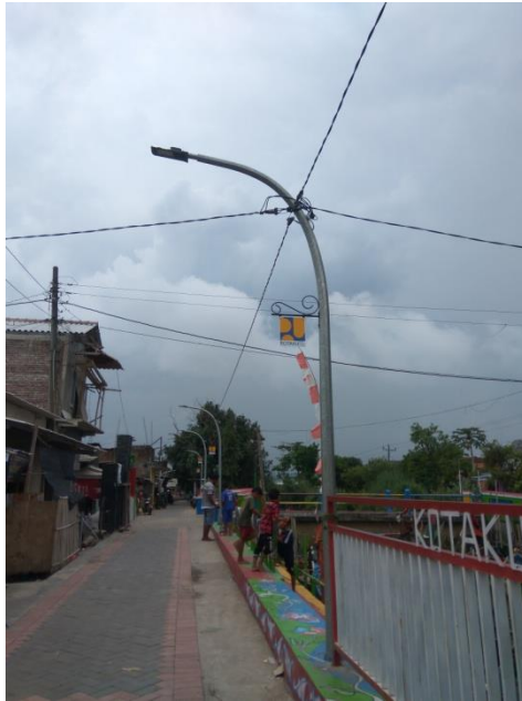
Kondisi Penerangan Jalan di RW 05
