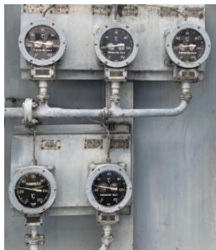
Gambar 2.2 Suhu Minyak Transformator
