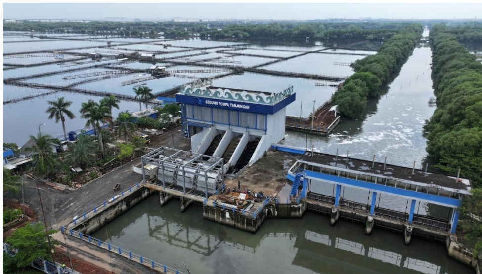
Gambar 2. 6 Gedung Pompa Tanjung, Jakarta Utara, DKI Jakarta
