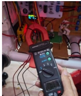
Berdasarkan hasil pengukuran tegangan dari multimeter seperti pada gambar 4.1, Terdapat selisih pengukuran sekitar 0,05V hingga 0.19V. Selain itu dilakukan juga pengukuran arus modul kontrol dengan Clamp meter seperti gambar 4.2
