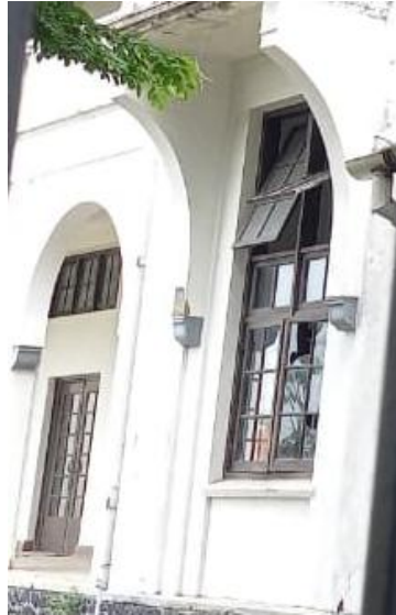
Gambar 20. Kondisi Kusen Pintu dan Jendela Sumber: Dokumentasi Pribadi
