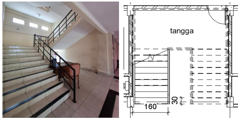
Gambar 4. 20 Kondisi Eksisting Tangga Rusunawa Undip Gedung E
