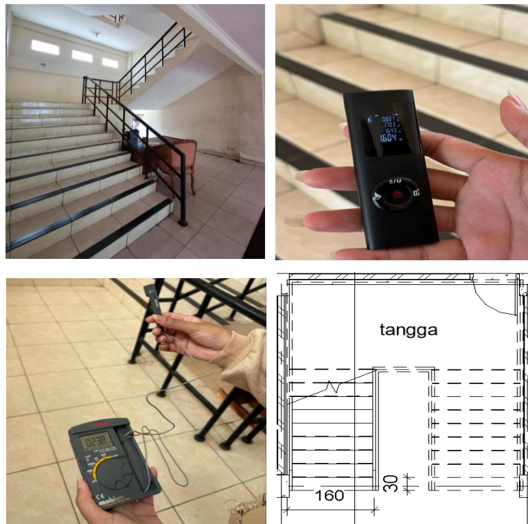
Gambar 4. 5 Kondisi Eksisting Tangga Rusunawa UNDIP Gedung E
