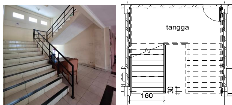
Gambar 4. 33 Kondisi Eksisting Tangga Rusunawa Undip Gedung E
