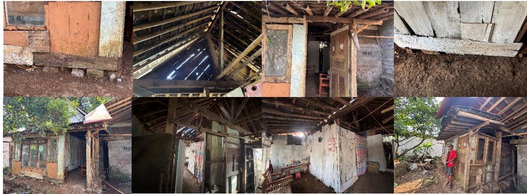
Gambar 27. Dokumentasi Visual Kerusakan Rumah Calon Penerima Bantuan (Sumber: Penulis)
