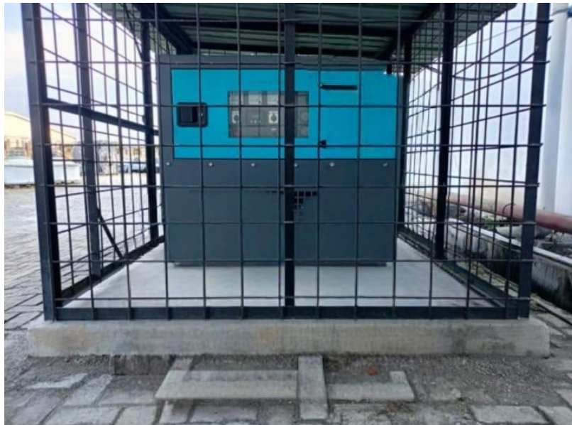
Gambar 4.8 Pengamanan Area Elektrik
