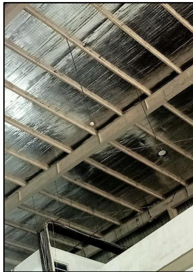
Gambar 4.10 Kondisi Lampu Penerangan Mati
