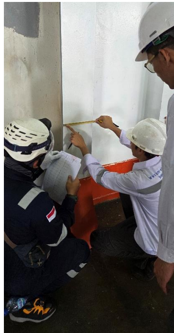
Gambar 4.8 Pengukuran Dimensi Aktual Web Frame Modified oleh Tim Teknis Galangan dan Surveyor BKI sebagai Bagian dari Final Inspection
