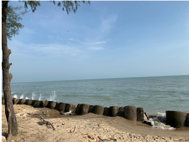
Gambar 1. 1 Kondisi Abrasi Pantai Caruban Kabupaten Rembang
