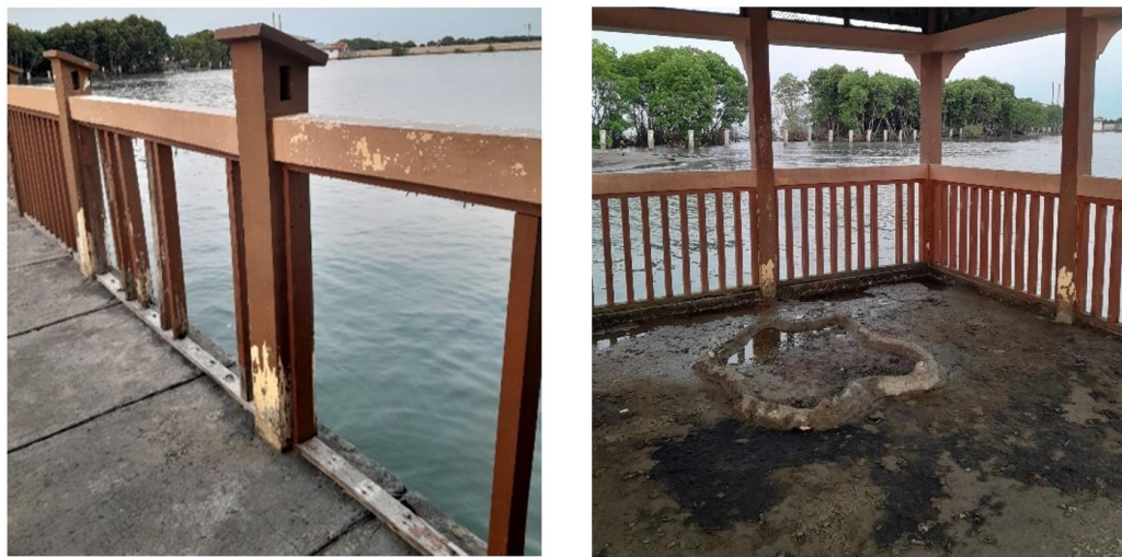
Gambar 1.1 Pembatas Jembatan Kayu Rusak dan Gazebo Kotor Berlumut
