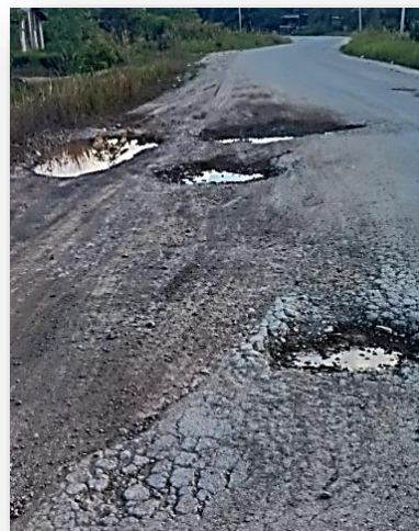
Gambar 1.1 Kerusakan Infrastruktur Jalan (Sumber: Hasil pengamatan dilapangan, 2021)
