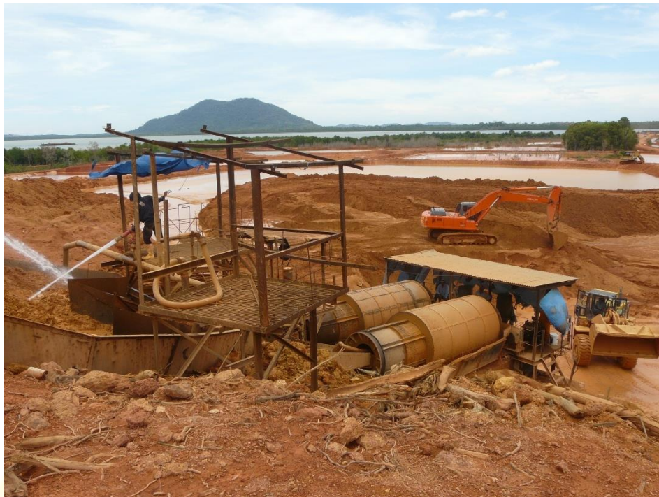
Gambar 2. 3 Fasilitas Pencucian Bauksit (Arsip Dinas ESDM Provinsi Kepulauan Riau, dokumentasi April 2010)
