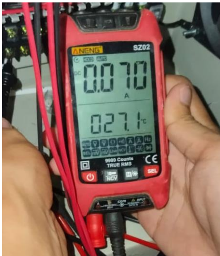
Gambar 4. 17 Pengukuran Arus Dosing Pump tanpa Beban
